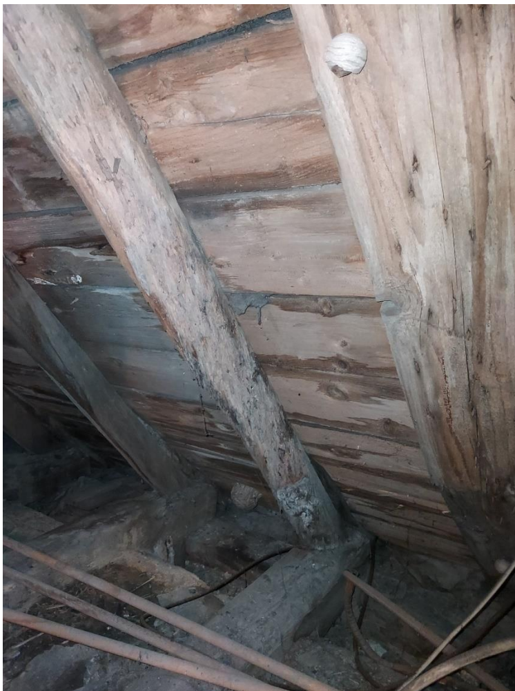
Feuchtigkeit, Schädlingsbefall und Schimmel- / Pilzbefall am Sparren und der Fußpfette
