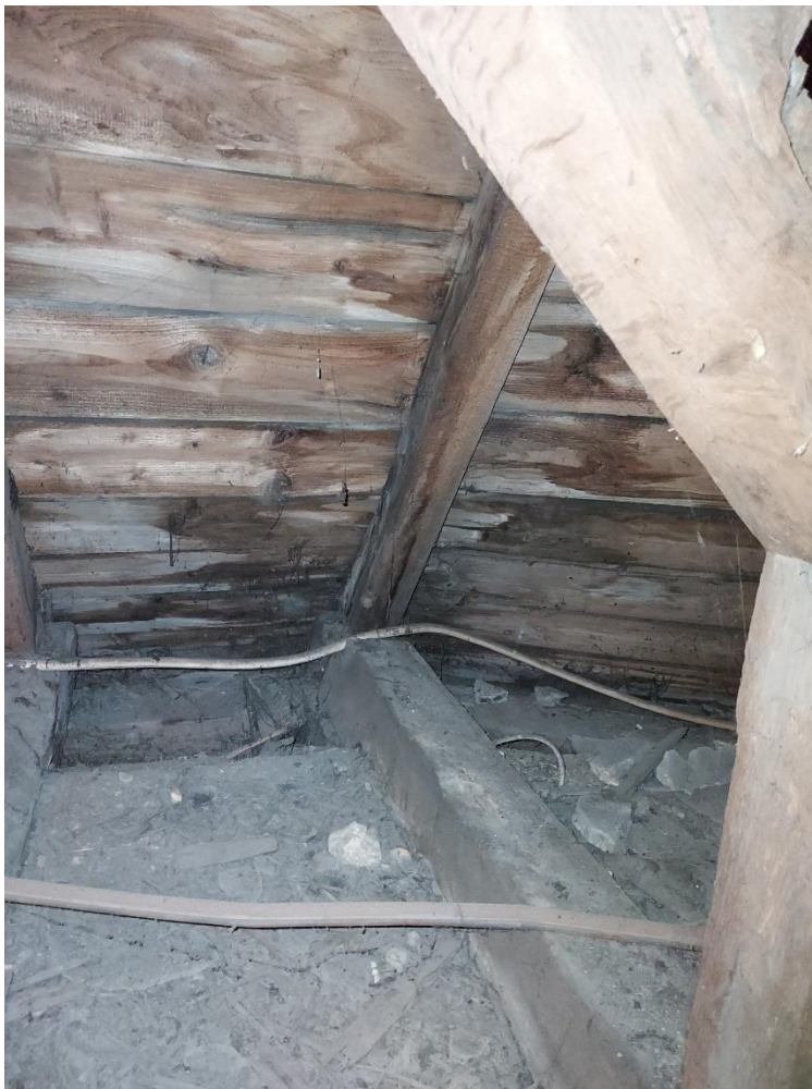
Feuchtigkeit / Nässe an der Rauspundschalung und dem Sparren, teilweise auch am Balkenkopf des, durch den Dachstuhl belasteten, Deckenbalkens
