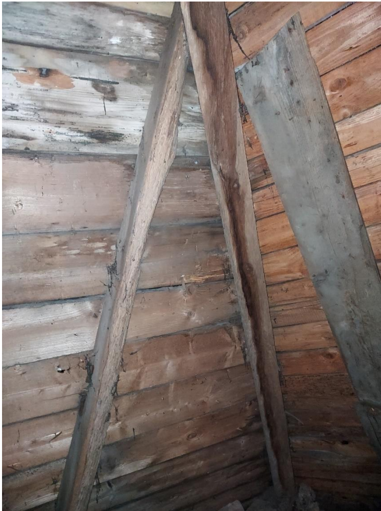
Feuchtigkeit / Nässe an der Rauspundschalung und dem Gratsparren
