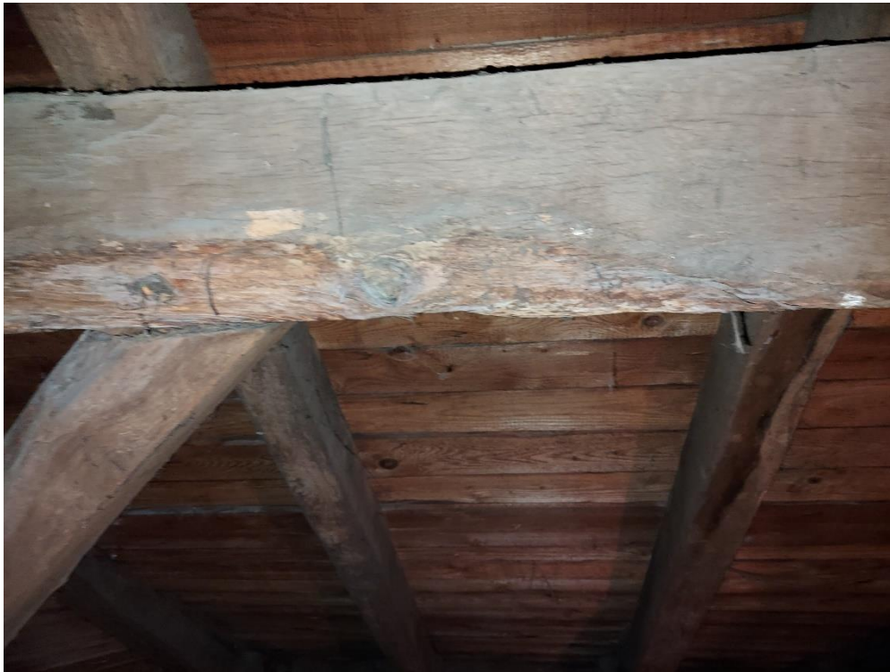
Schädlingsbefall an der Mittelpfette
