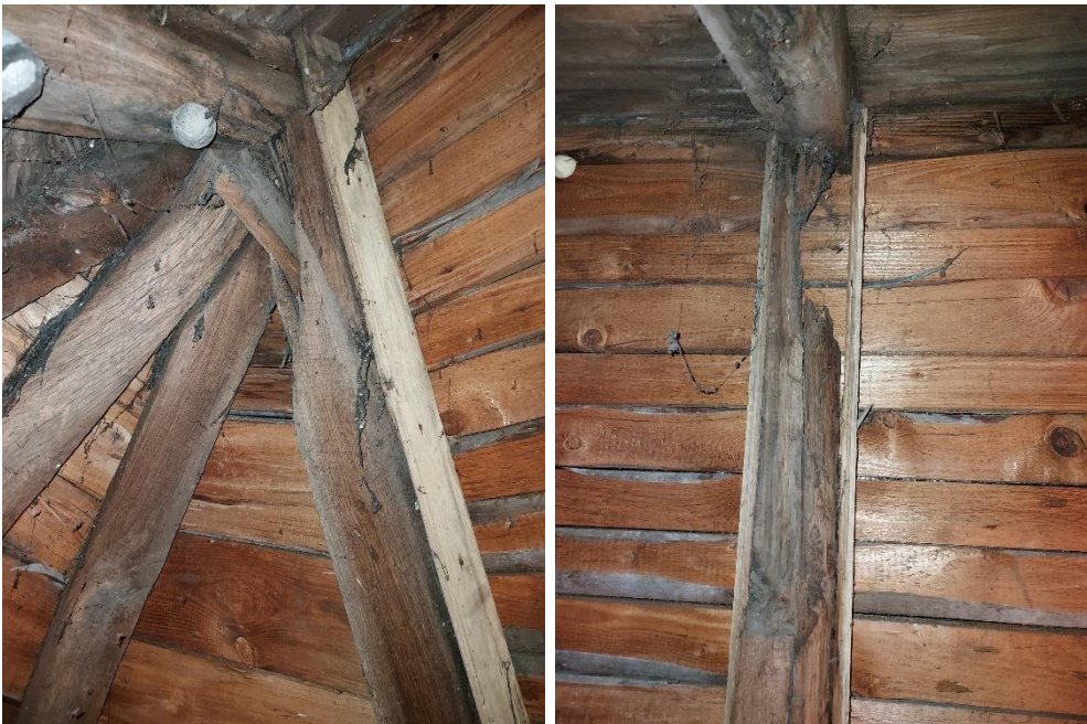
Gebrochene Sparren, notdürftig repariert
