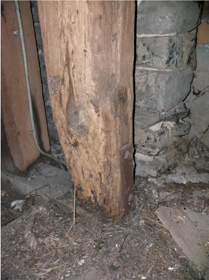
Durch Feuchtigkeit beschädigte Stützen des Glockenturms
