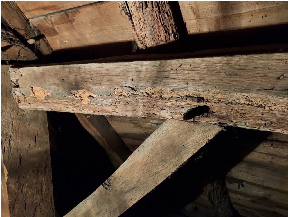
Schädlingsbefall an der Mittelpfette und Sparren
